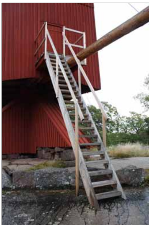
Kvarntrappan inklusive räcken och handledare på såväl trappa som kvarnbro har ersatts med kopior av föregående. Foto Lotta Wistrand, Stockholms läns museum
