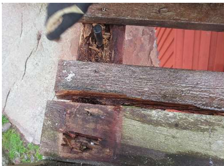
Kvarnbrons bärande bjälkar och golv hade ruttnat. Foto Rolf Hammarskiöld 2023-08-28
