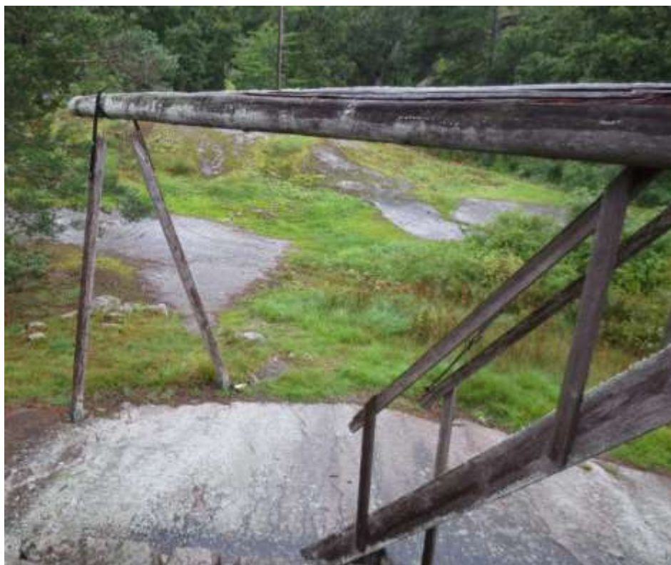
Kvarnhästen/stjärtbalken och yttertrappan behöver bytas. Foto Rolf Hammarskiöld 2023-08-28
