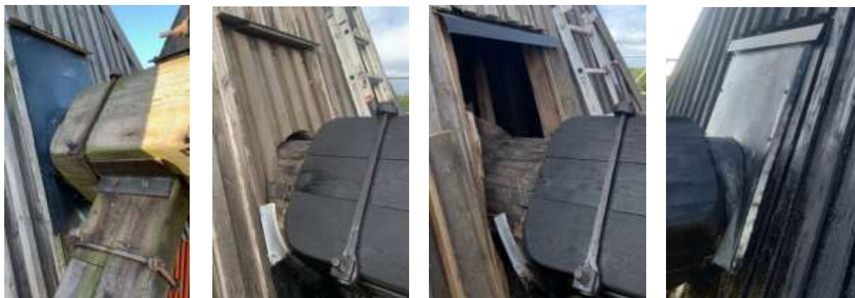
Vid vingaxelns genomföring hade ett läckage uppstått, därför att droppblecket ovanför var otillräckligt. För byte av droppbleck krävdes tillfällig demontering av panel och täckplåt kring vingaxeln.
